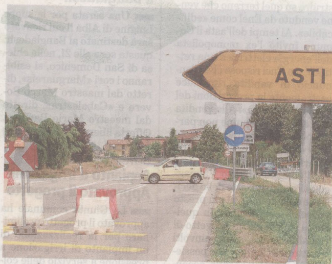
Il punto in cui è interrotta per lavori la statale Cuneo-Asti [SILVIA MURATORE]
